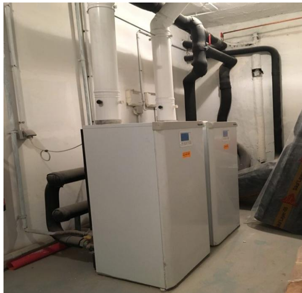
Chaudière à condensation - Le Vésinet (siège d'ARTEA)
