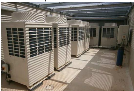
Pompes à chaleur réversible
