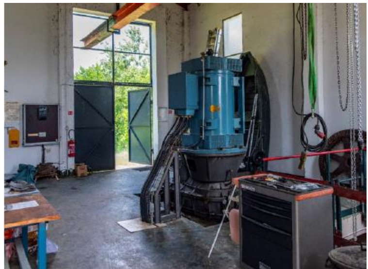
Photographies de la centrale hydroélectrique d'Onard
